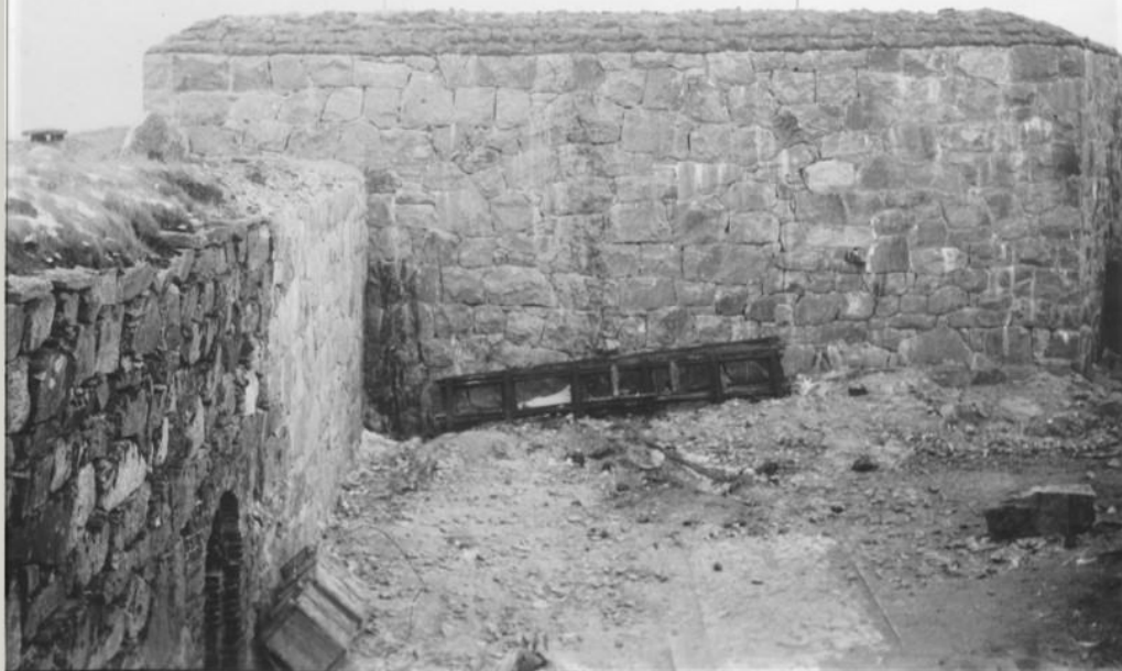
Västra hornets flank och del av kurtinen efter konservering, dock före Fogstrykning. Krön isolerat med jordvall
