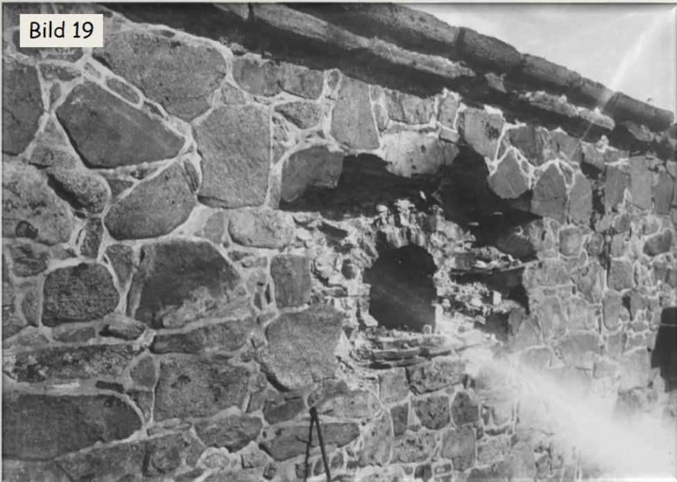
Ventilglugg före restaurering. Se 22 där den visas färdig
